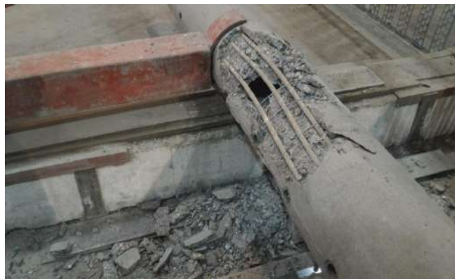
Рисунок 7 - Стойка опоры № 4 на испытательном стенде после разрушения
